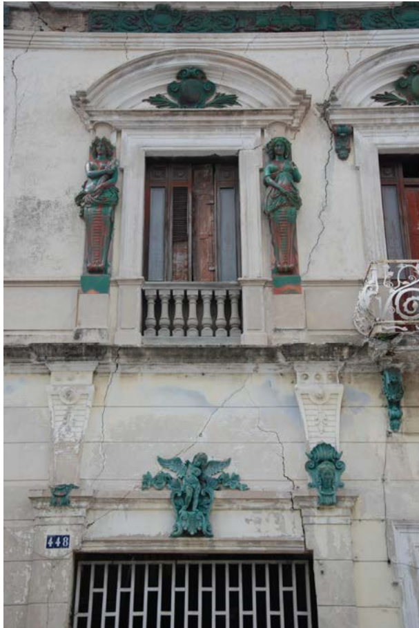
Ya se cayó la cara de la guapa muchacha, ojalá que no caiga el resto de la fachada. Calle 59 por 54 y 52.
