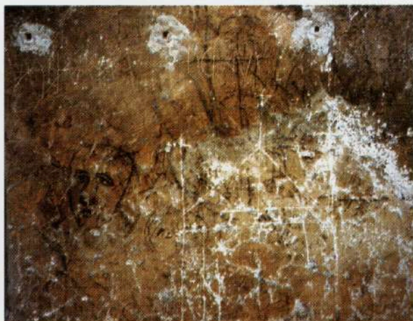
Graffiti en la torre sur
